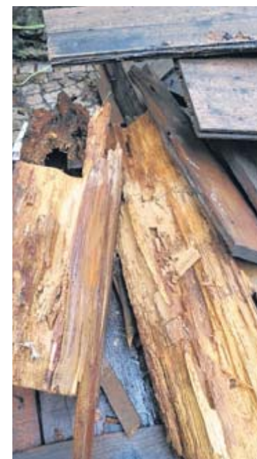
An der Holzkonstruktion wurde Schwamm sichtbar. FOTO: PRIVAT
